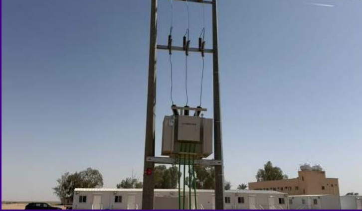
عمود المحول ضمن الموقع TRANSFORMER POLE WITHIN THE SITE
