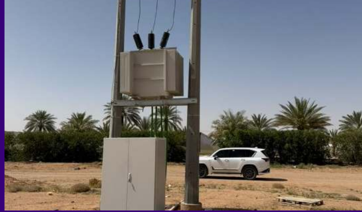
عوازل وقواطع علوية INSULATORS AND OVERHEAD SWITCHGEAR
