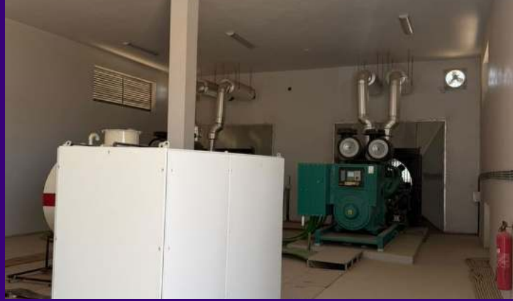
خزان الوقود ولوحة التحكم FUEL TANK AND CONTROL PANEL
