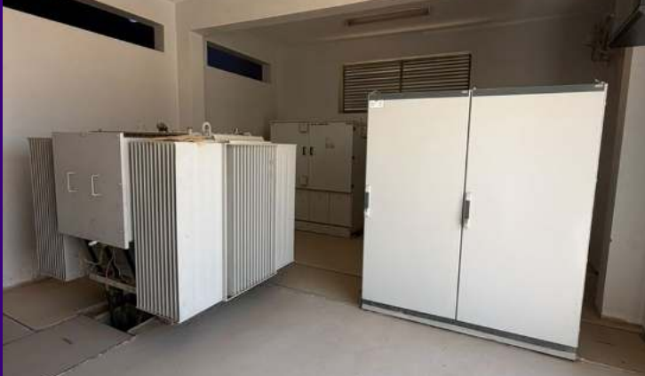
لوحات التوزيع الأرضية FLOOR-STANDING DISTRIBUTION BOARDS
