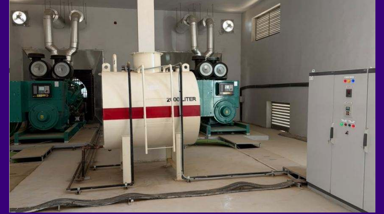
غرفة المولدات — مولدان احتياطيان GENERATOR ROOM — TWO STANDBY SETS
