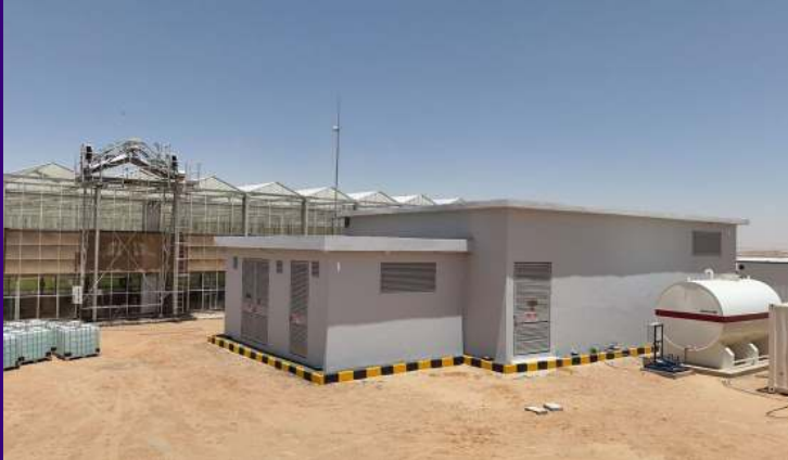
المحطة بجوار البيوت المحمية SUBSTATION ADJACENT TO THE GREENHOUSES
