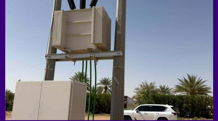
محول هوائى وصندوق كابلات POLE TRANSFORMER AND CABLE BOX
