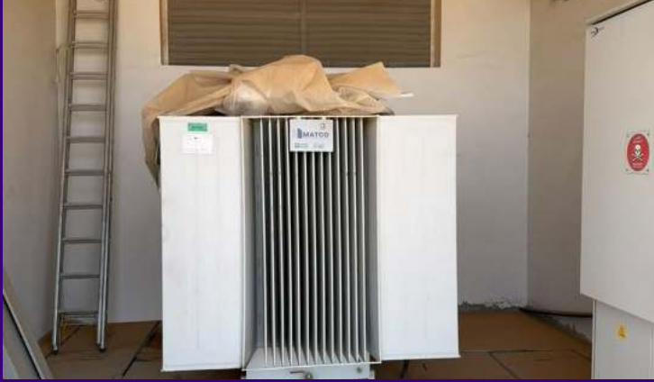
المحول ومسارات الكابلات TRANSFORMER AND CABLE ROUTES
